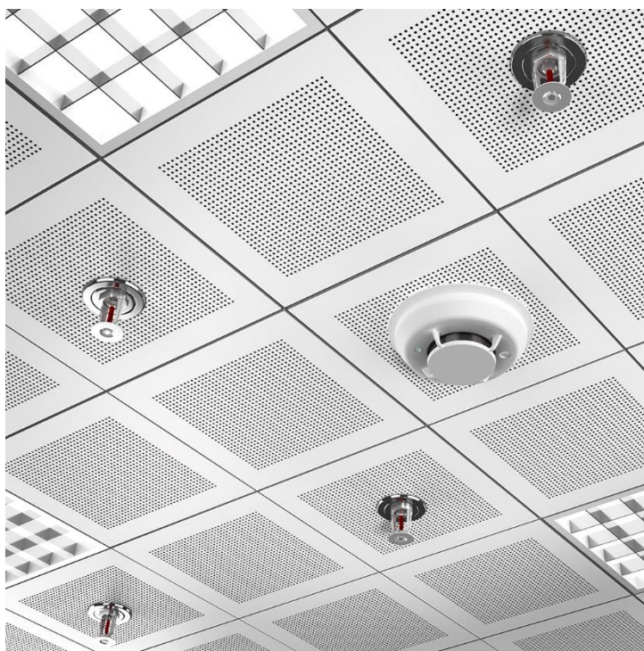
Slika 10. – Automatski sustav stropnih prskalica za gašenje požara ( Izvor: https://www.tehnomobil-elsting.hr/media/k2/attachments/Stabilni-sustavi-gasenje-pozara.pdf )
